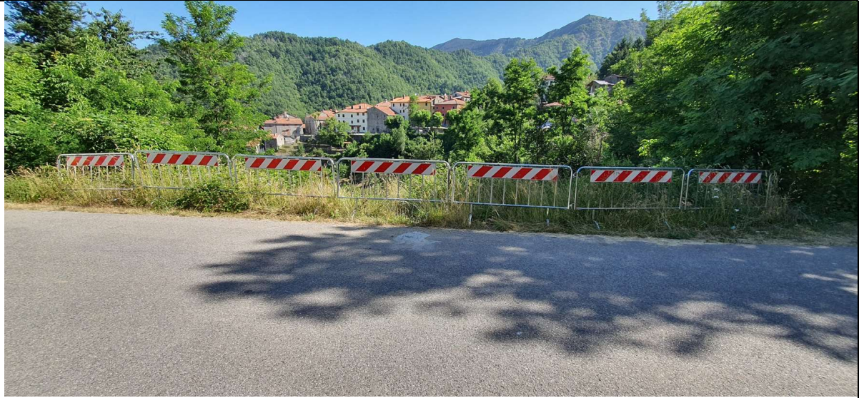
Foto 3 - Sede stradale in corrispondenza del fenomeno franoso. Al limite della pavimentazione, il tombino carrabile del sondaggio geognostico.
