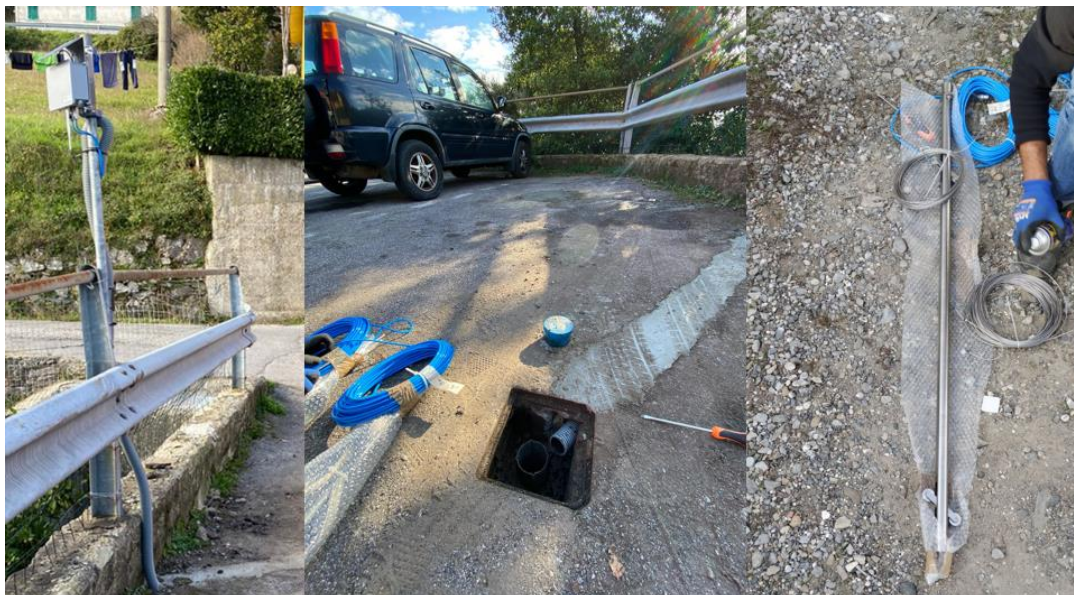
Figura 9 – Foto della centralina wifi e della sonda inclinometrica installata in corrispondenza del foro di sondaggio I1.
