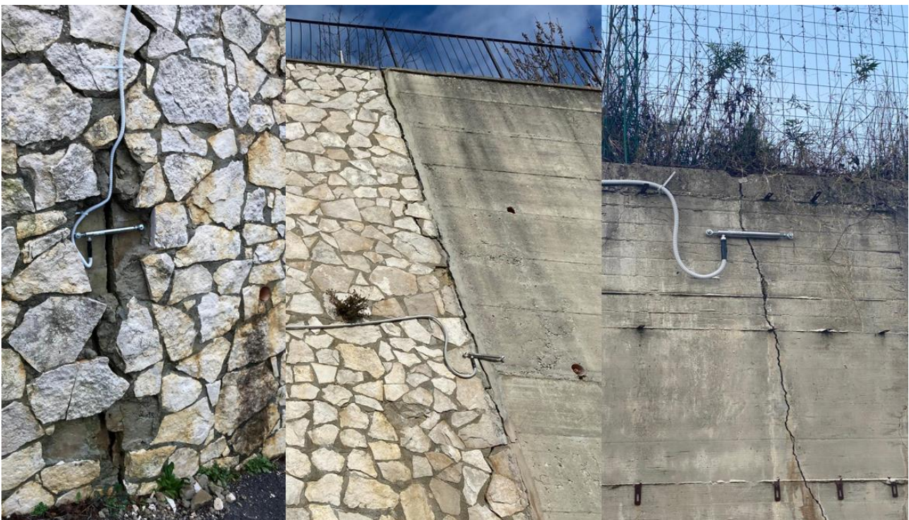
Figura 14 – Fessurimetri installati sulle fratture presenti sui muri di contenimento nell'intorno del sondaggio I3 (prime due foto da sinistra) ed I2 (foto sulla destra).
