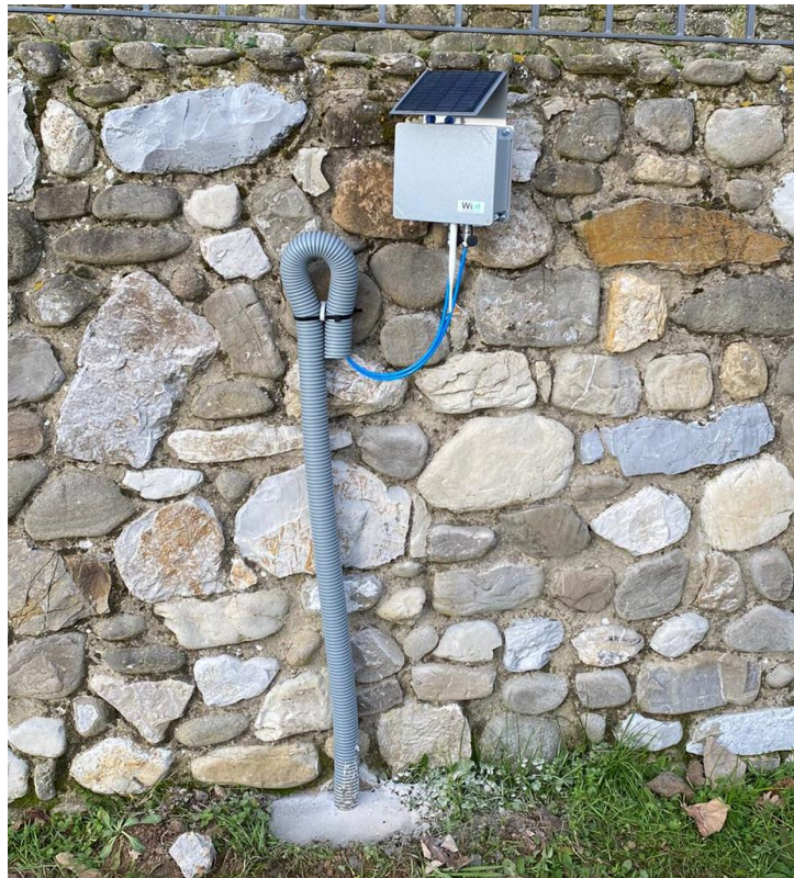
Figura 3 – Nodo coordinatore (datalogger wifi) dotato di modem GPRS per il trasferimento dei dati on line e di pannello solare per la ricarica delle batterie che alimentano il nodo ed i sensori connessi ad esso via cavo.
